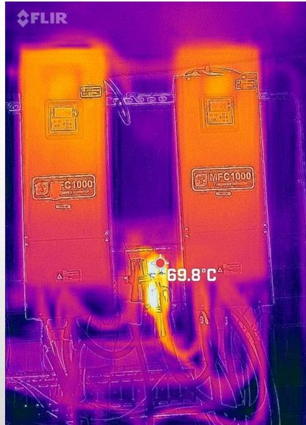
Falowniki MPC 1000 widok z kamery termowizyjnej
